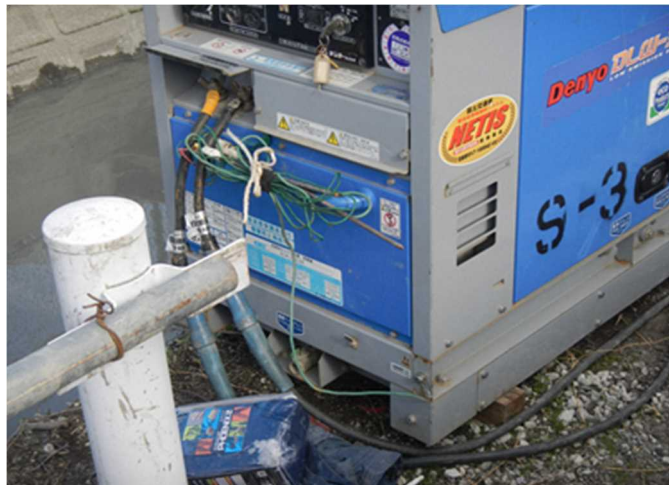
【写真5】 発電機設置状況
