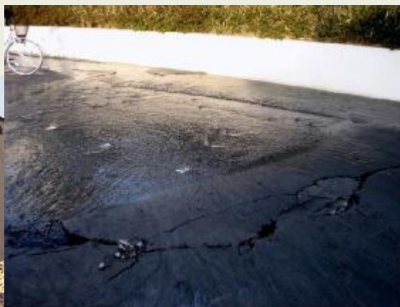
断水(水道管破損による漏水) (東日本大震災 千葉県船橋市)震度6弱
