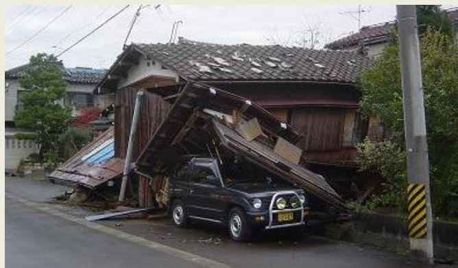
建築物の倒壊(中越震災)震度6弱
