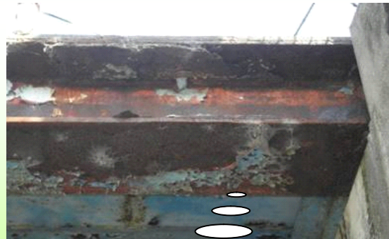
鋼製の橋桁の塗装が劣化し、錆が広範囲に発生していました。
