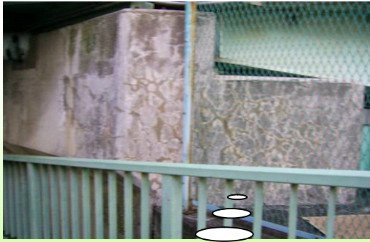
橋脚（橋を支える脚）にひびわれが多数発生していました。
