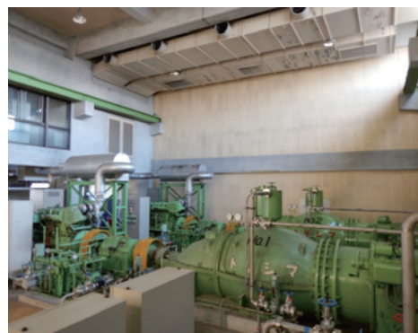
ポンプ場(五軒堀排水機場)の内部
