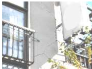
取付け壁面のひび
