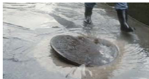
浮き上がってずれたマンホールのふた
