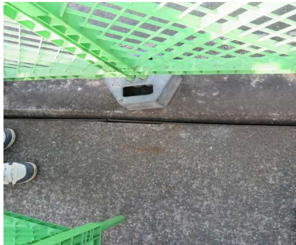
写真6 車道部地覆と歩道部の境界部
