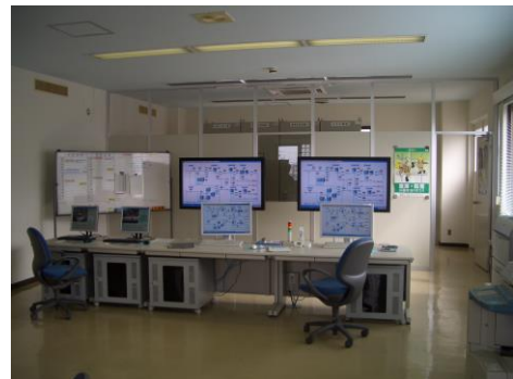
< 中央管理センター >
