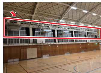
設置されたエアコン
