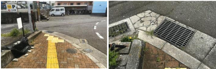
グレーチングの改善
