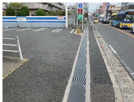
●グレーチングの改善
