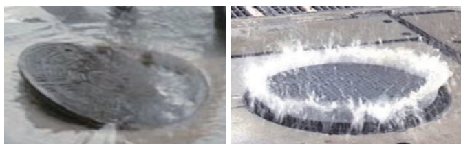
浮き上がってずれたマンホールのふた 浮上防止ロック機能付きマンホール
