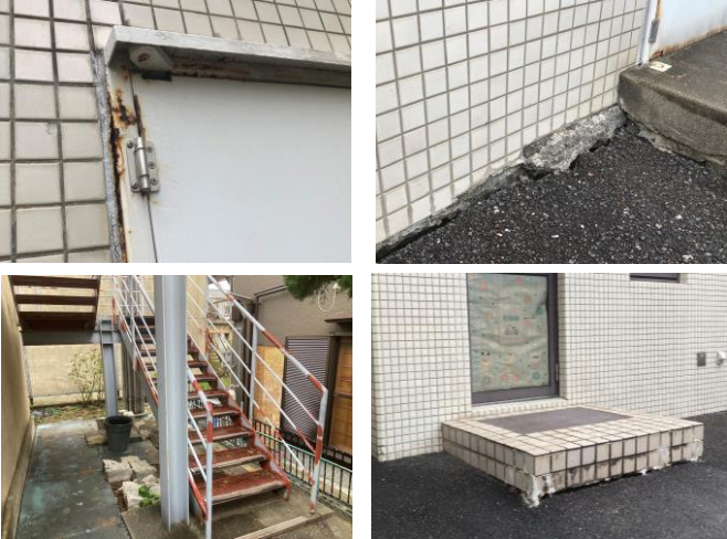
建物等の老朽状況（地盤沈下、鉄部錆 など）
