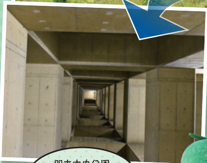
朋来中央公園 地下の流域調節池 貯留量：47,000㎡！
