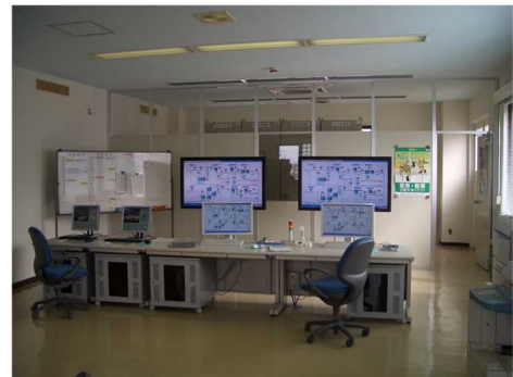
<中央管理センター>
