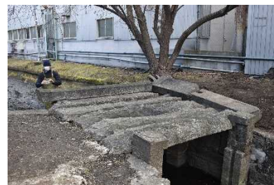
笠石が破損した樋門（深野南町）
