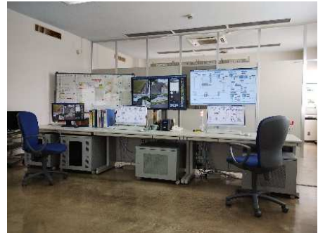
<中央管理センター>
