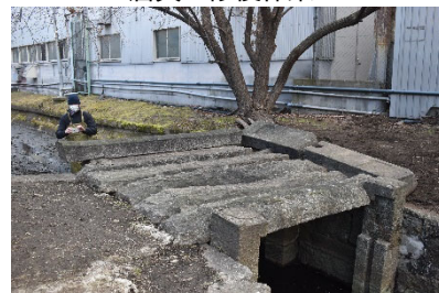
笠石が破損した樋門(深野南町)
