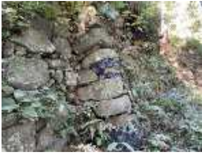
図 119 一部の石材が散失した石垣 (石垣 69)
