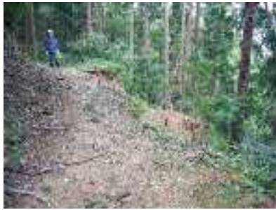
図 123 崩壊した曲輪法面
