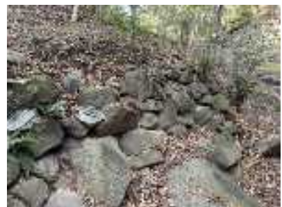
図 118 崩壊が進んでいる石垣 (石垣 89)
