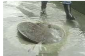
浮き上がってずれた マンホールのふた
